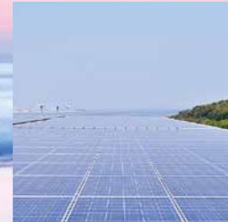
MEGA SOLAR Power System メガソーラー
